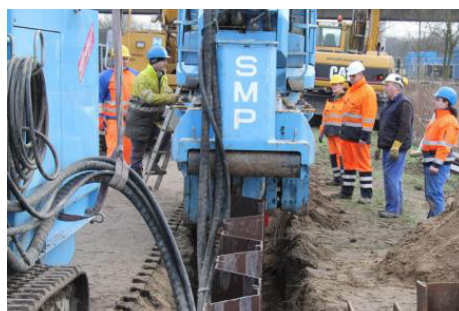
Diese hydraulische Presse drückt im Bereich der Schleuse die 6,50 Meter langen Spundbleche in den Boden. Sie ragen über das Geländeniveau heraus, bieten so einen besseren Schutz
