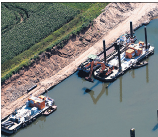
Im Unterwasser der Schleuse sind die schwimmenden Einheiten Matthäi 100, Matthäi 101 und Matthäi III zu sehen.
