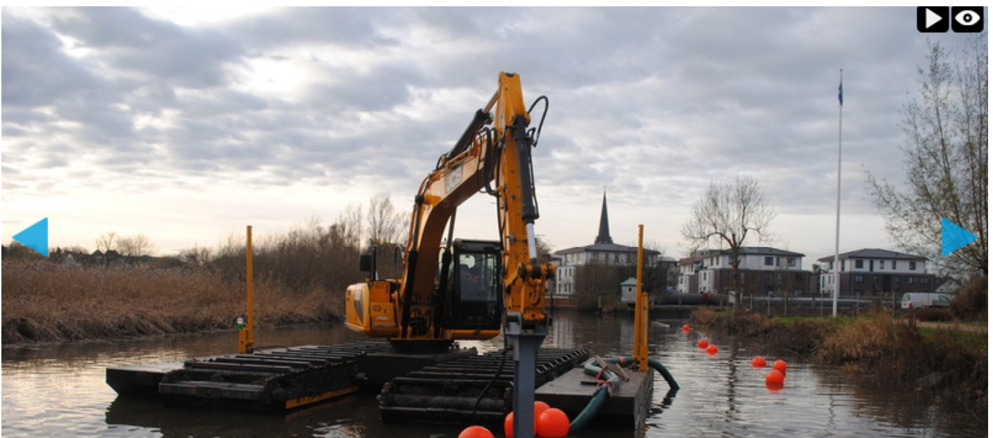
Der Schwimmbagger von Matthäi Wasserbau hat damit begonnen, die Este und den Hafen in Buxtehude tieferzulegen. Foto: Vasel
